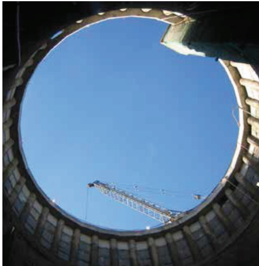
Blick aus dem 40 Meter tiefen Hauptangriffsschacht «Brunnenhof»: Ausgefachte Pfahlwand im Bereich der Moräne, darunter eine Spritzbetonsicherung im Molassefels. (Bild: Stephan Frank)
